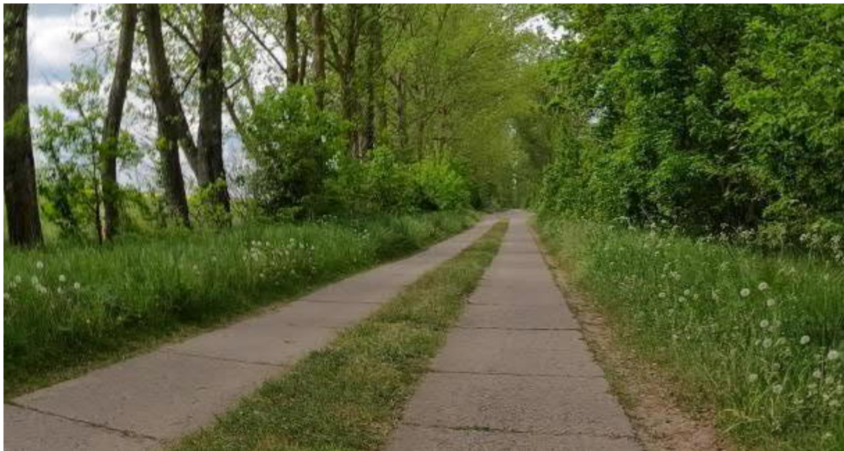
Abbildung 3: Zustand Weg im Norden - Am Tempelfelder Weg 3
