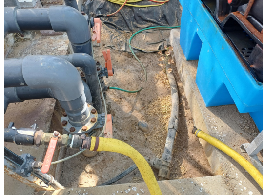
Leitungsverlauf um den Wassertank.
