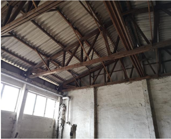
Abb. 25; Lagerhalle an der südlichen Grenze des Plangebiets mit Habitatpotenzial für Fledermäuse und Gebäudebrüter
