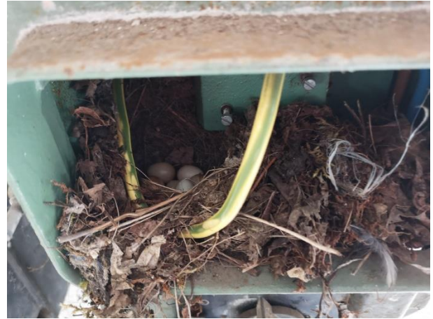
Abb. 16; Lagerhalle an der westlichen Grenze des Plangebiets mit Nest Hausrotschwanznest im Elektro-Verteilerkasten
