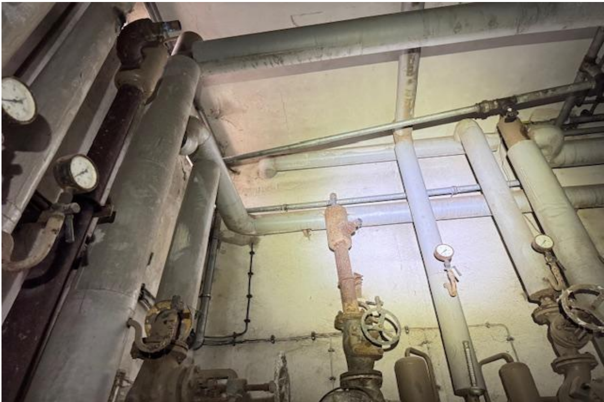
Innenansicht Gebäude VW, Heizungsanlage Keller
