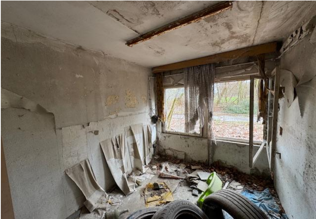
Gebäude PF Innenansicht; Bachstelzennest am linken Fensterrand
