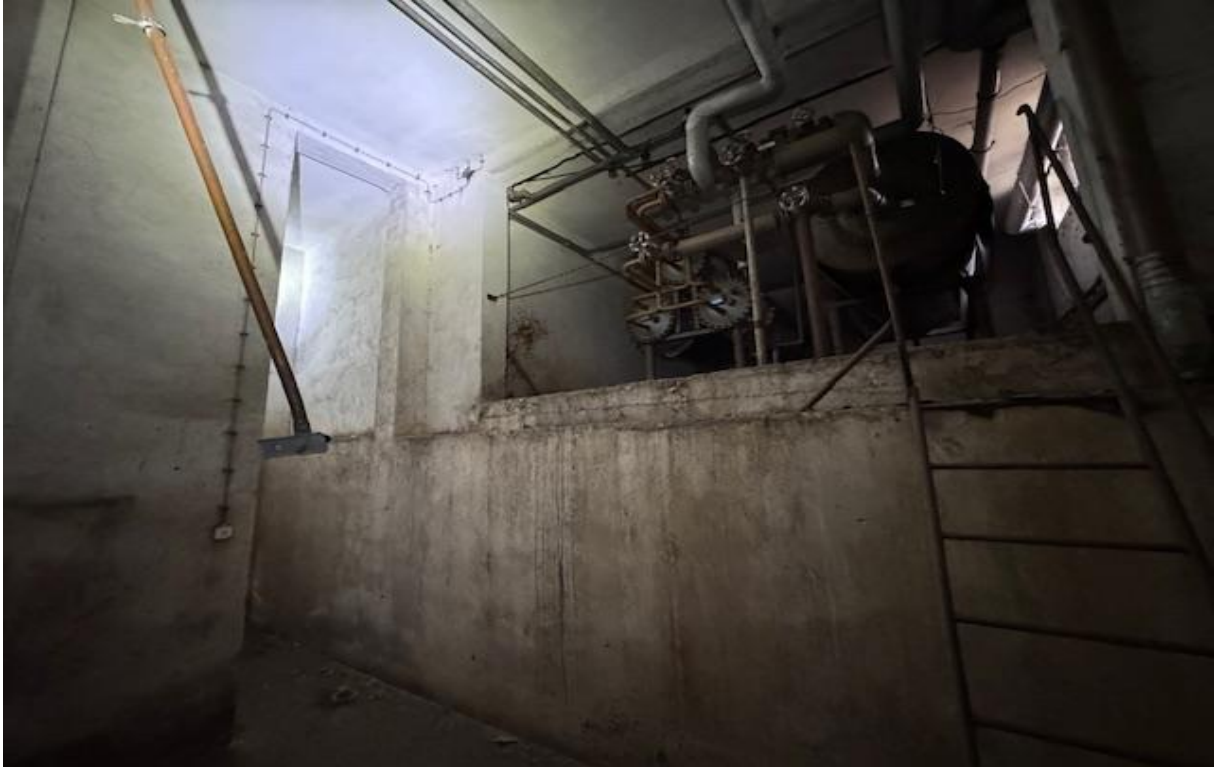
Innenansicht Gebäude VW, Heizungsanlage Keller
