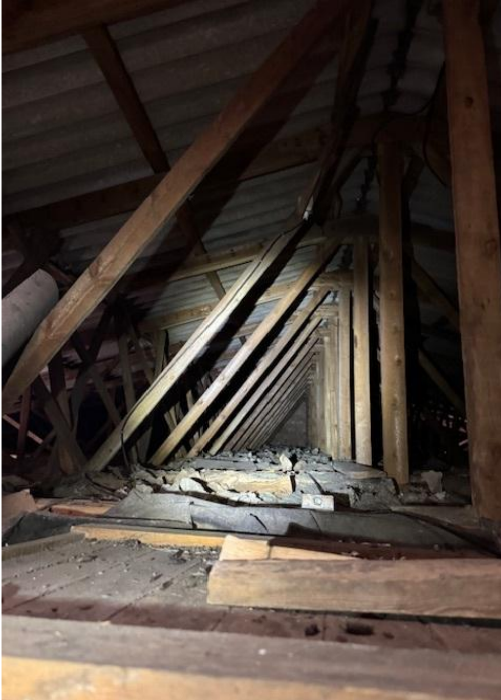
Innenansicht Gebäude VW, Dachboden; Kot Waschbär und Marder
