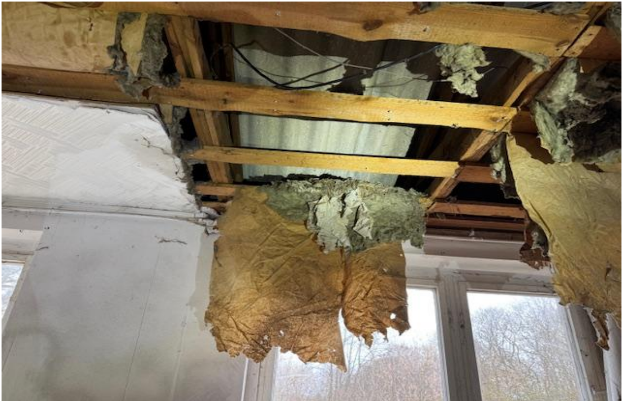
Innenansicht Gebäude VW; Spuren Waschbär und Marder
