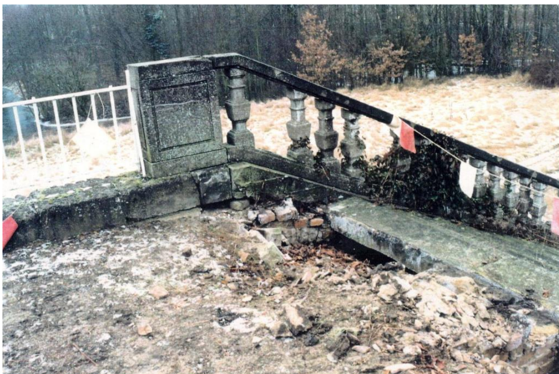
Abb. 182: Unterspülung der rechten Treppe nach Abbau der oberen zwei Stufen, 1992 (Gutachten 1992, Foto S. 39 oben)
