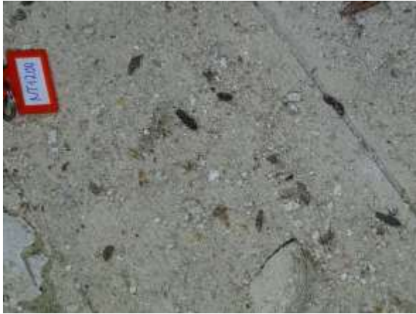
Abbildung 41: Kotkrümel auf Dachboden
