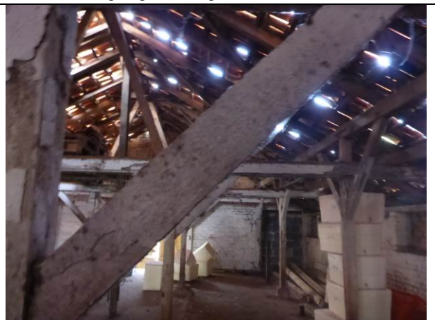
Abbildung 35: ehemaliger Pferdestall, über offenes Dach gut zugänglich
