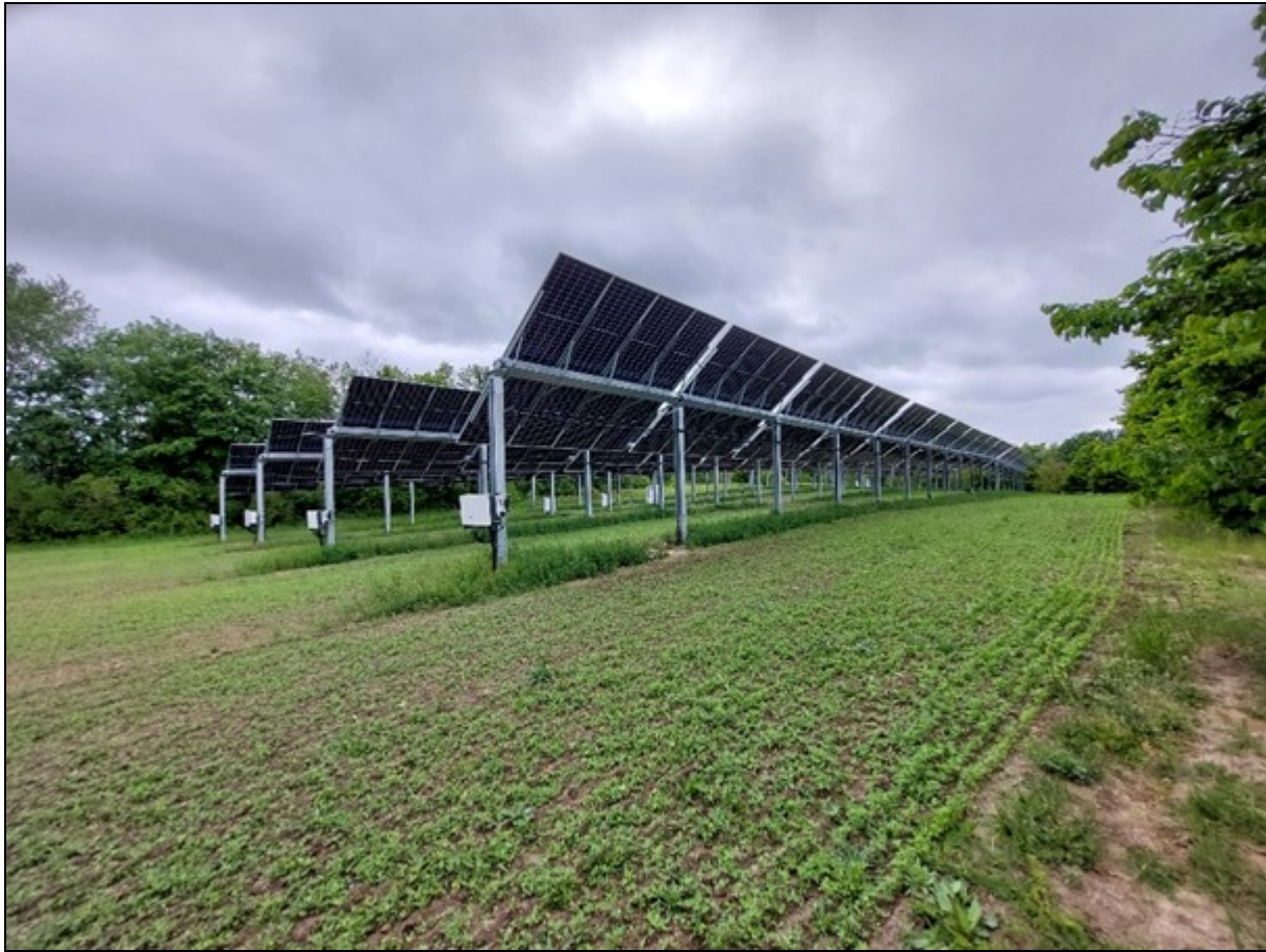
Abb. 10: Agri-PV-Modellanlage ZALF Müncheberg (Referenzanlage mit engeren Reihenabständen von ca. 10 m und größerer Durchfahrtshöhe von 4,60 m)
