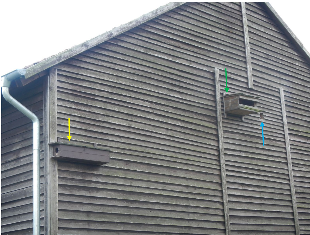
An der Giebelwand der Scheune sind Nistkästen für Steinkauz (gelber Pfeil), Turmfalke (grüner Pfeil) und die Einschluöffnung für Schleiereulen (blauer Pfeil) zum innenliegenden Brutkasten angebracht.
