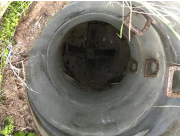
7: Schacht an Abscheideranlage
