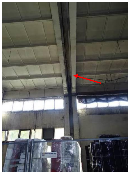
Abbildung 21: Spalt zwischen Deckensegmenten
