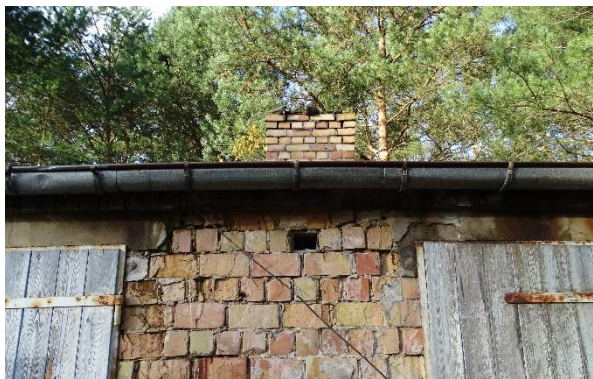
Abbildung 39: Öffnung im Mauerwerk und Spalten am Kamin am Hundezwinger
