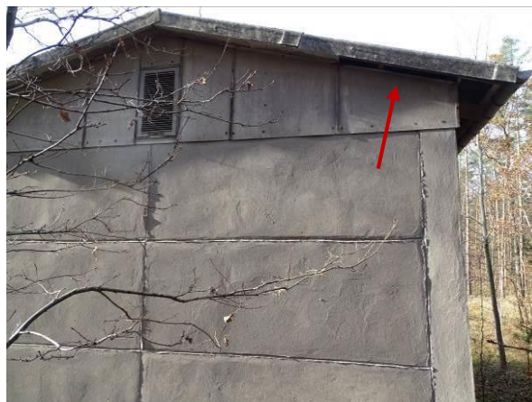
Abbildung 58: Nordostecke mit Öffnung im Dachbereich (roter Pfeil)
