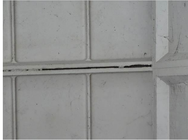
Abbildung 62: Spalten zwischen Betondeckenteilen im Detail
