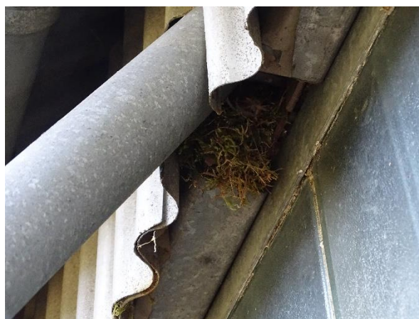
Abbildung 50: Nischenbrüternest in Metallverkleidung
