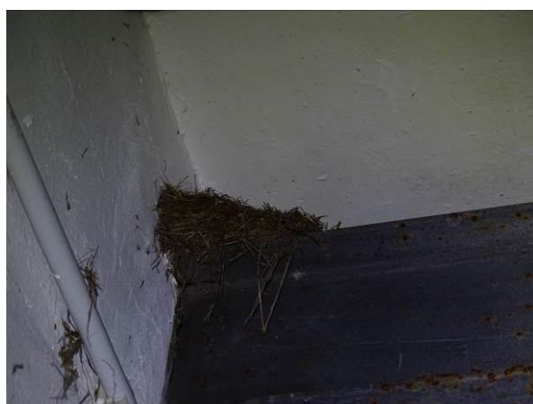
Abbildung 42: Nischenbrüternest auf Stahlträger in Gebäude 5
