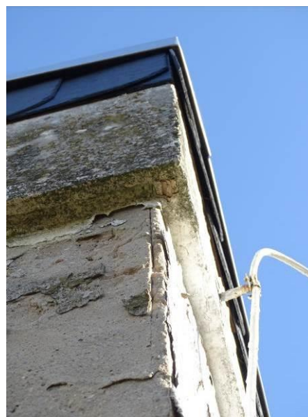
Abbildung 66: Spalt hinter Schieferplatten
