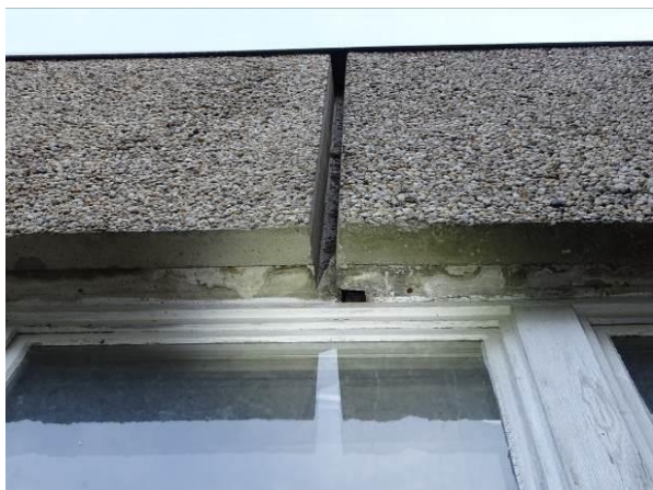
Abbildung 29: Spalt zwischen zwei Platten
