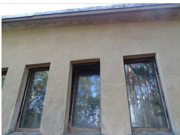
Abbildung 41: Gebäude 5, gekipptes Fenster
