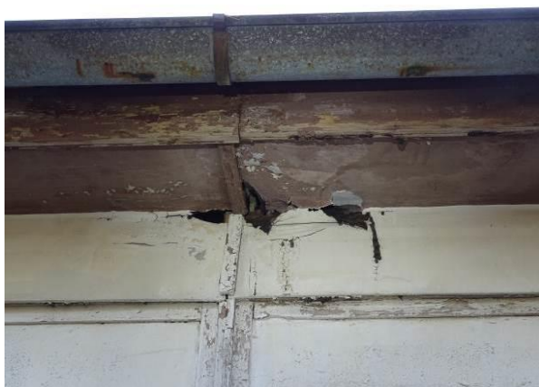
Abbildung 33: Loch am Übergang zum Dach auf der Westseite der Klubbaracke
