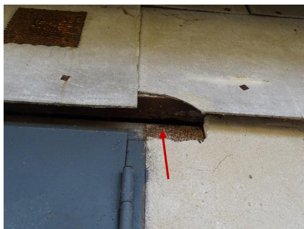
Abbildung 44: Spalt an Verkleidung
