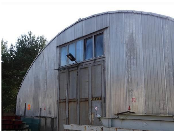
Abbildung 49: Halle 1/3 mit zwei gekippten Fenstern
