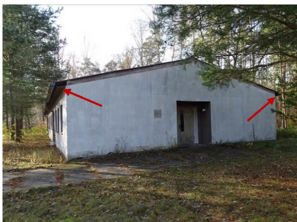
Abbildung 37: Baracke mit offenen Dachkästen (rote Pfeile)
