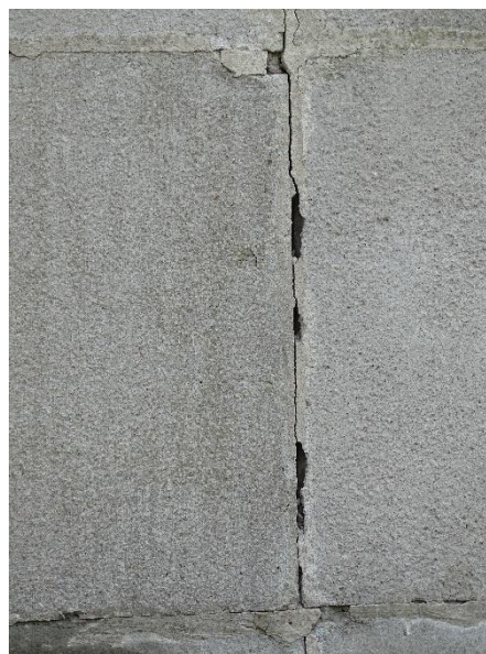
Abbildung 56: Spalt an Halle 20
