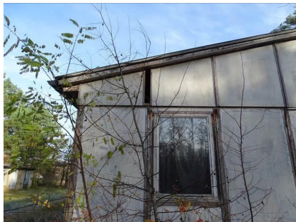
Abbildung 34: Spalt in Holzverkleidung an der Südseite der Klubbaracke
