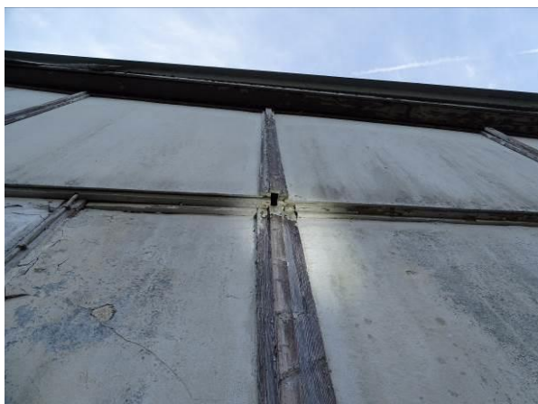
Abbildung 31: Spalt in Holzverkleidung an der Nordseite der Klubbaracke
