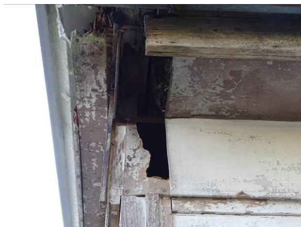
Abbildung 32: Einflugmöglichkeit zum Dachkasten und Innenraum an nordwestlicher Ecke Klubbaracke
