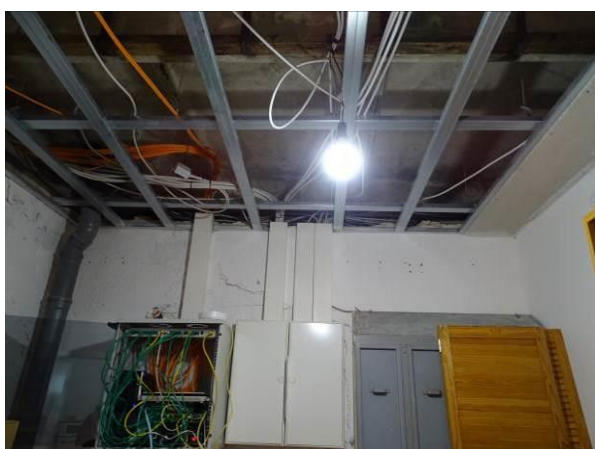
Abbildung 69: Technikraum mit teilweise abgehängter Decke
