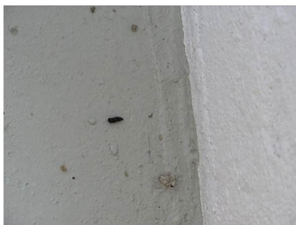
Abbildung 70: Kotkrümmel im Technikraum
