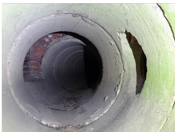
Abbildung 76: Nischen innerhalb des Rohrs
