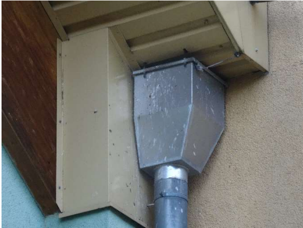
Niststätte des Stars an der westlichen Fassade der Sporthalle
