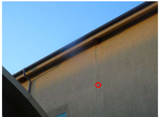
Relevanter Fassadenbereich mit Loch
