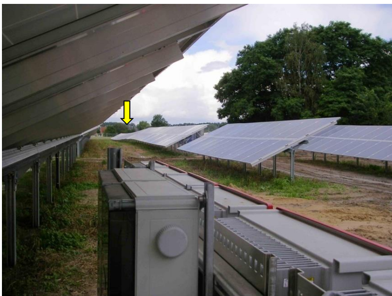
Abb. 31: Beispiel aus dem Solarpark Kremmen für die höhenmäßige Anpassung der Modulreihen an das Gelände. Der Pfeil zeigt eine Verwerfung, die für die Funktionstüchtigkeit der Photovoltaikmodule ohne Bedeutung ist. (Foto RIK: P7120009.JPG)
