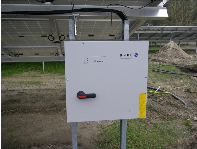
Abb. 24: Beispiel für einen unter den Modultischen stehenden Stringwechselrichter (hier PVA „Alte Poststraße“ Friesack, Zootzen). (Foto RIK: P1010014_2023-04-18)
