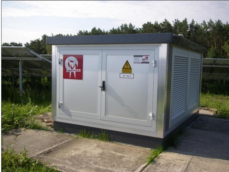
Abb. 25: Beispiel für einen Transformator, der den Wechselstrom von 400 V auf 20 KV hochtransformiert (hier PVA „Alte Poststraße“) Friesack, Zootzen). (Foto RIK: P1010052_2023-07-13)
