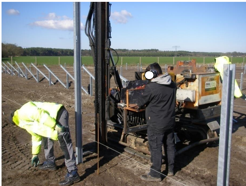
Abb. 21: Die Rammtechnologie der Modultische (hier PVA „Alte Poststraße“ Friesack, OT Zootzen). (Foto RIK: P1010011.JPG)
