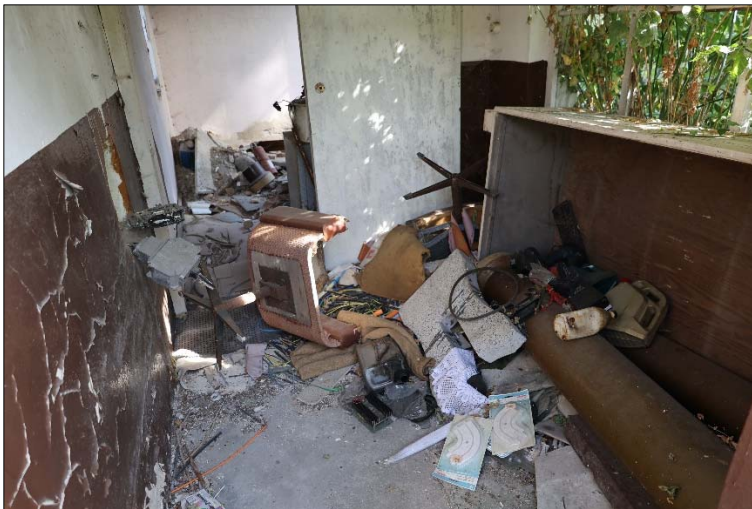
Abbildung 9: Die Innenräume des Bürogebäudes sind verwahrlost und vermüllt Geltungsbereiches; Aufnahme 08/2024
