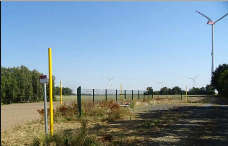
Abbildung 31: Löschwasserentnahmestelle mit Hydrant an Zuwegung zu vorhandener WEA
