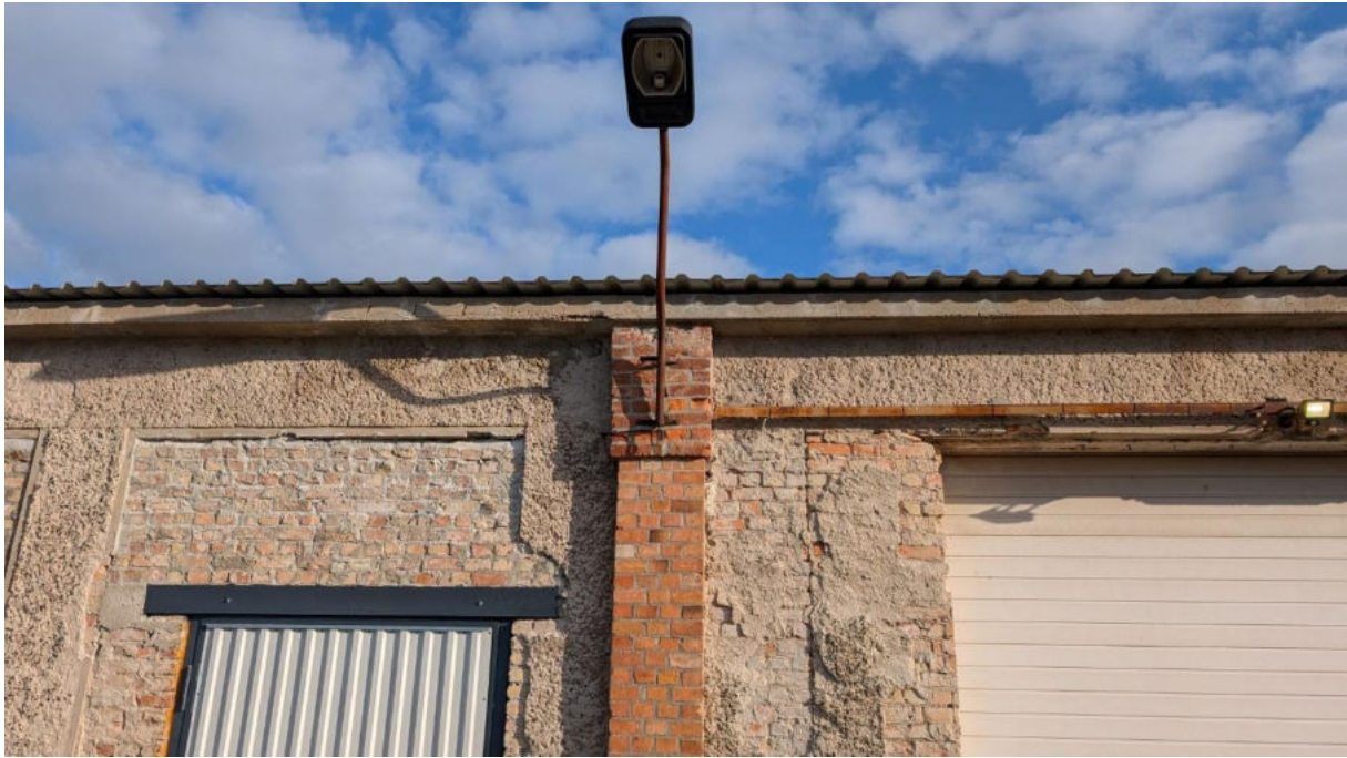
Abbildung 27 zwei Nistplätze des Haussperling unter der Dacheindeckung des Flachbaus in Privatbesitz
