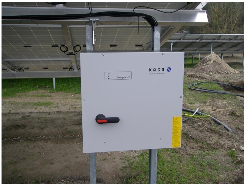
Abb. 8: Beispiel für einen unter den Modultischen stehenden Stringwechselrichter (hier PVA „Alte Poststraße“ Friesack, Zootzen). (Foto RIK: P1010014_2023-04-18)
