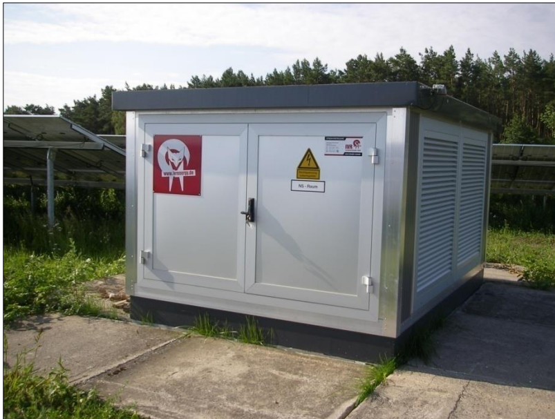
Abb. 9: Beispiel für einen Transformator, der den Wechselstrom von 400 V auf 20 KV hochtransformiert (hier PVA „Alte Poststraße“) Friesack, Zootzen). (Foto RIK: P1010052_2023-07-13)
