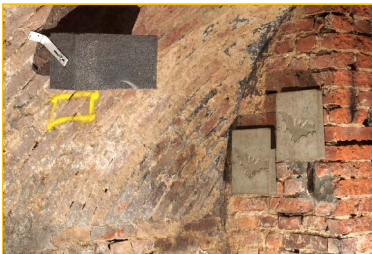
Abb. 25: Beispiel für die Anbringung von Verstecken in Fledermauswinter- quartieren: Gewölbestein 1GS und Fledermaus- wandschale 2FE der Fa. Schwegler im Eiskeller Dahlem, Berlin.
