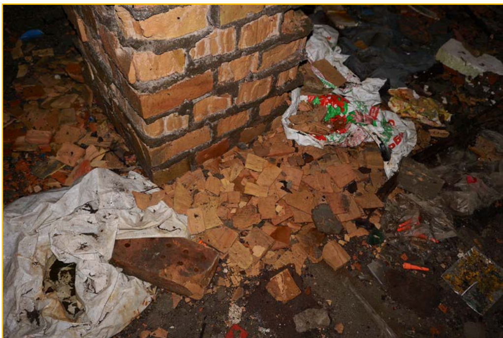
Abb. 15: Schäden am Mauerwerk sind ein deutlicher Hinweis auf Frost.
