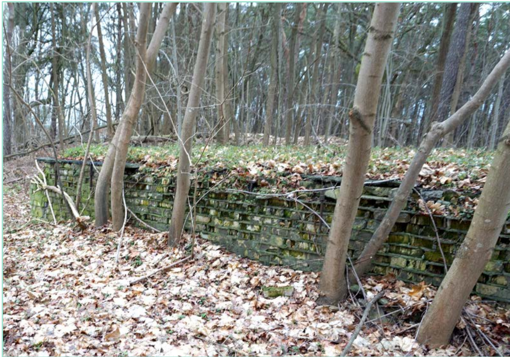
Abb. 22: Ein Entfernung von Gehölzen am Randes des Bauwerks trägt zur langfristigen Stabilisierung und Sicherung des Objektes bei.
