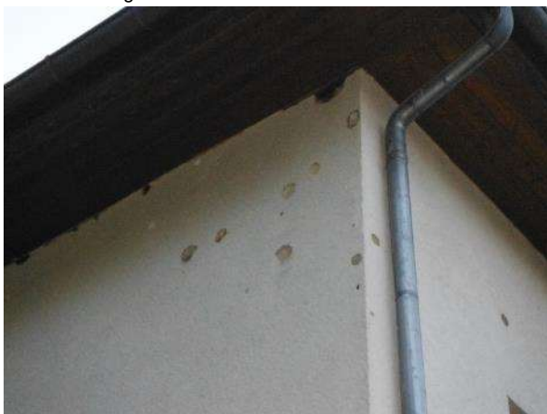
Abb. 10: Mehrzweckhalle Südseite; Löcher von Mauerseglern regelmäßig angefliegen
