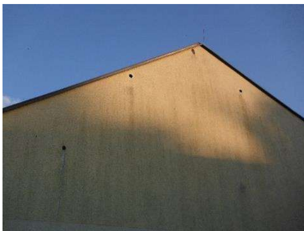
Abb. 4: Schulhauptgebäude nördlicher Giebel; Loch links unten vom Star besetzt
