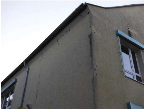
Abb. 6: Schulhauptgebäude südöstliche Fassadenseite; linkes Loch vom Mauersegler besetzt
