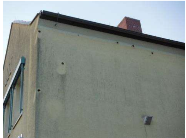
Abb. 7: Schulhauptgebäude südwestliche Fassadenseite; keine besetzten Löcher
