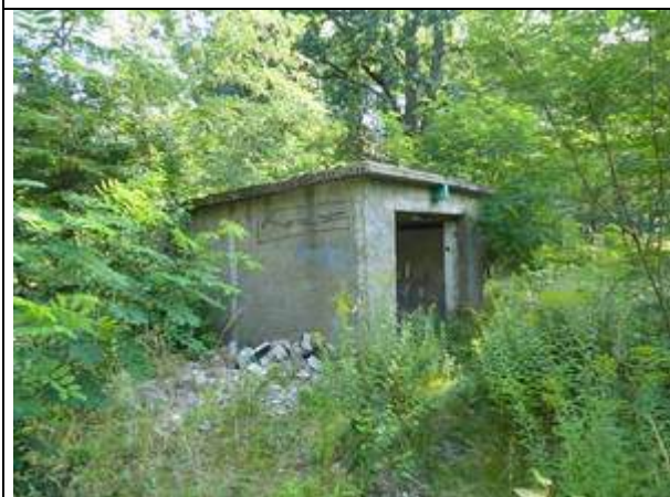
Foto 29: Gebäuderuine im Nordwesten des ehemaligen Hundeplatzes auf dem Flurstück 567 (Foto: Wiesner, 9.8.25)
