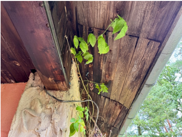
Abb. 14: Risse und Spalten innerhalb der äußeren Vertäfelung
