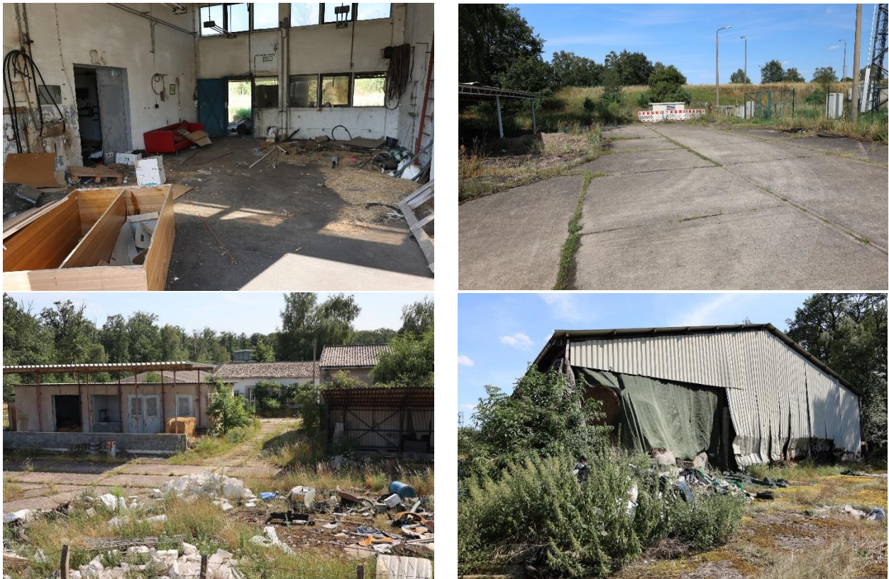
Abbildungen 16: Aktuelle Ausprägung der Rückbauobjekte und Flächenentsiegelungen bei der Ortslage Paulinenaue; Aufnahme: H. Roßmann 07/2024
