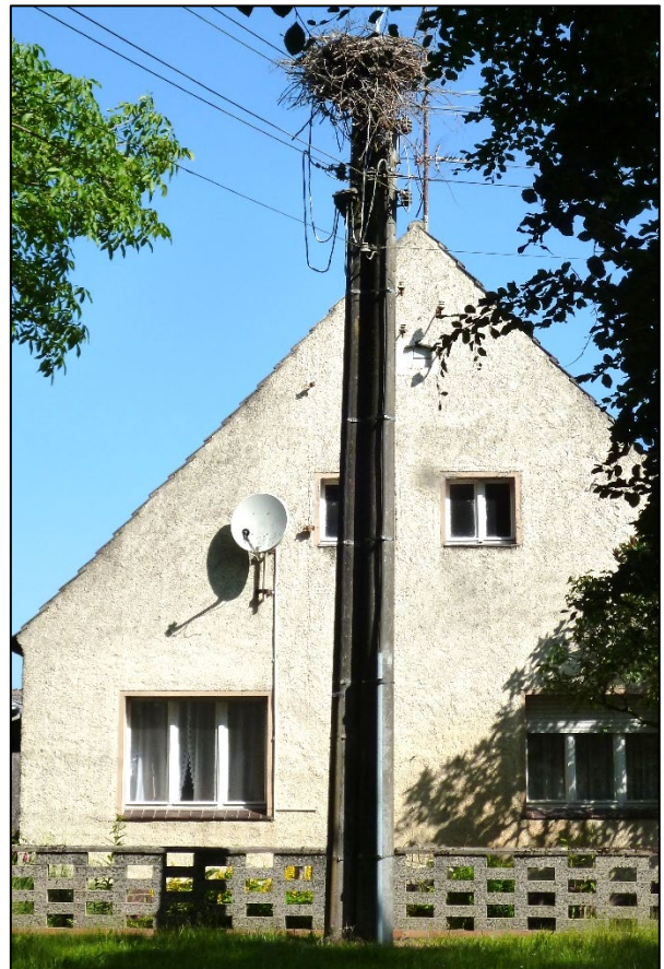
Abb. 35 Eintrag von Nistmaterial durch Weißstorch (Nr. 16) auf Mittelspannungsmast im Siedlungsbereich Münchhausen, bereits mit Abwehreinrichtung ausgestattet
