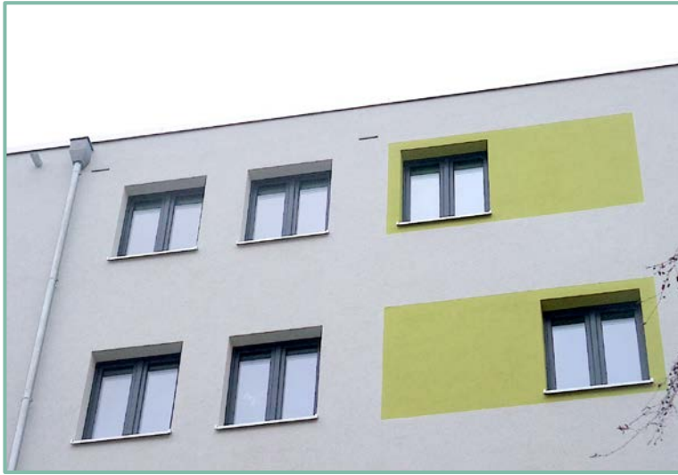
Abb. 14: Integration von Fledermaus- verstecken (Fledermauseinlaufblende 1FE) in einen Neubau. Eckertstraße 3A, 4A, 5A, Petersburger Straße 72D, 72E in Berlin-Friedrichshain, 2019.
