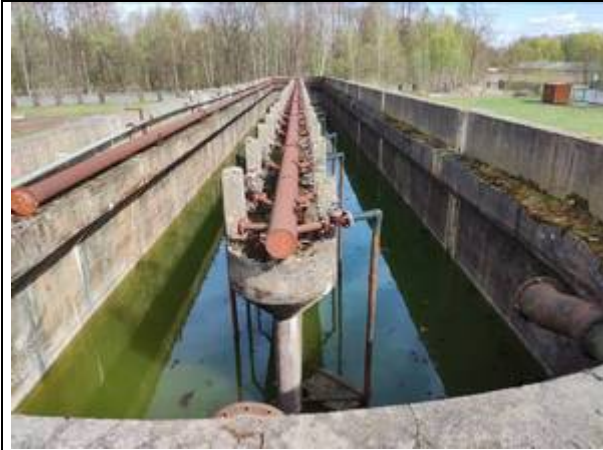
Foto 5: Belebtschlammbecken in der SOBF1 (Foto: Wiesner, 5.4.24)
