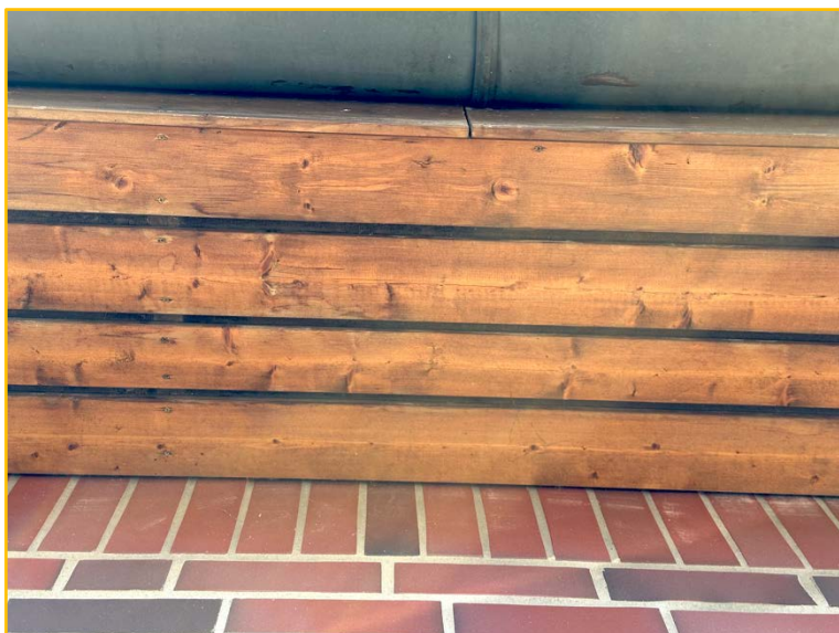
Abb. 10: Karl-Marx-Str. 36 Großziethen: Der Dachkasten bietet Fledermäusen keine Versteckmöglichkeiten und Gebäudebrütern keine Nist- möglichkeiten.
