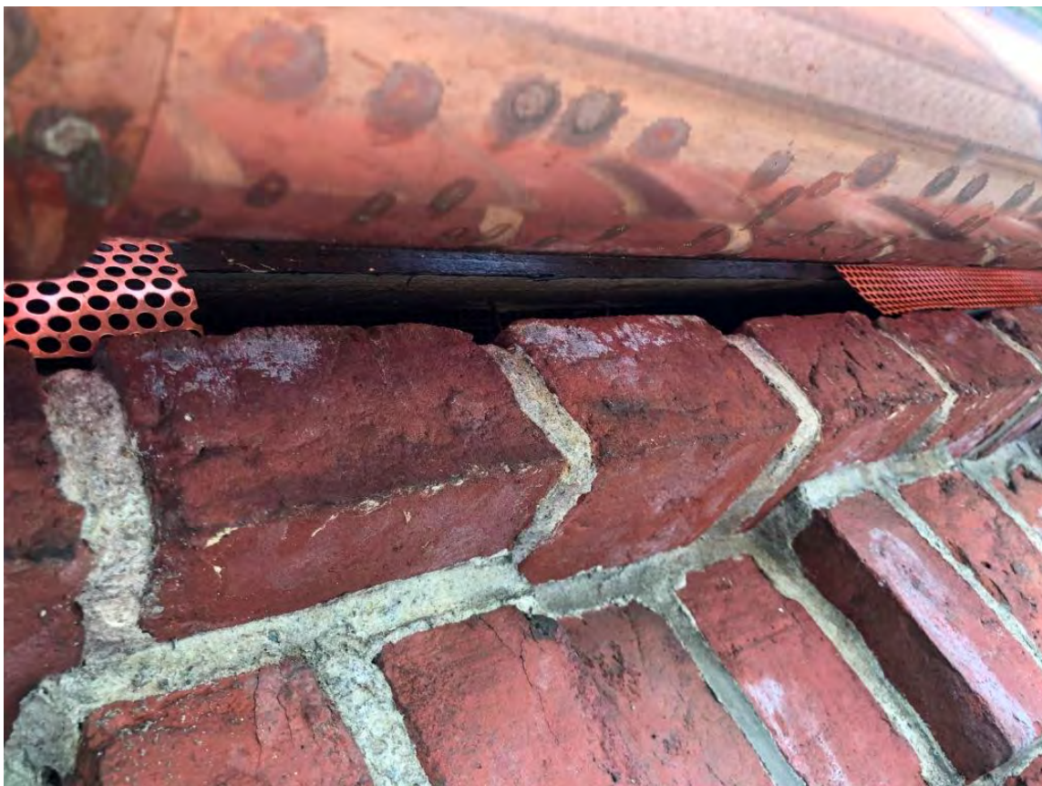
Abbildung 10: Einflugmöglichkeit nach Fertigstellung unterhalb Dachrinne (Anzahl an Einflugmöglichkeiten pro Dachraum muss gesondert festgelegt werden).
