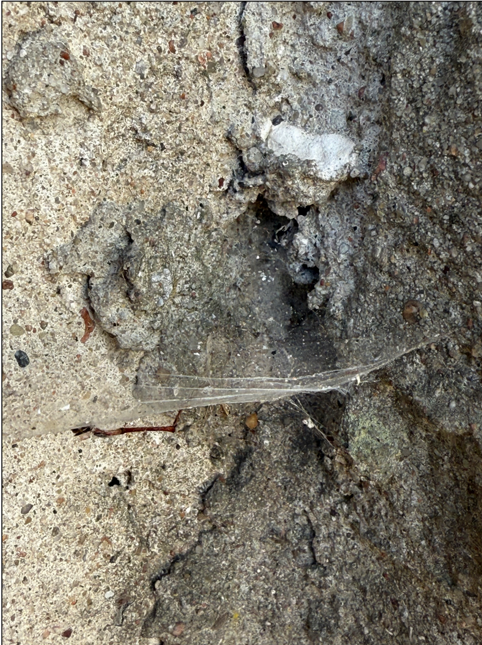
Abbildung 1: Außenansicht eines Nebengebäudes mit Spuren natürlicher Alterung. Deutlich erkennbar sind zugängliche, jedoch nicht genutzte potenzielle Einflugöffnungen für Fledermäuse.
