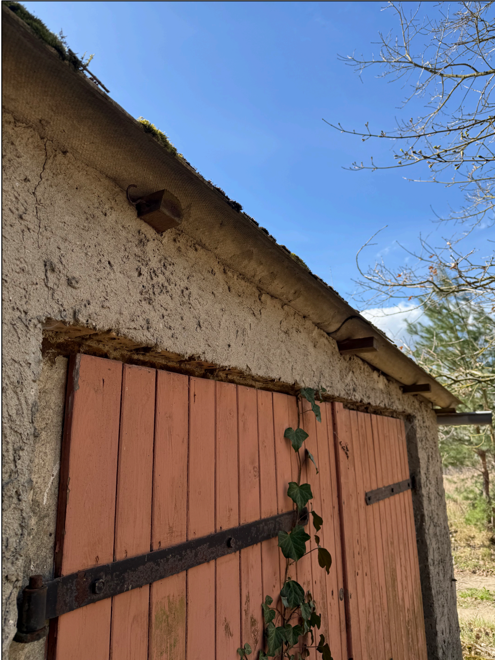
Abbildung 5: Dachbereich mit typischer Altbausubstanz. Keine frischen Spuren von Quartiernutzung, Einflugöffnung vorhanden, aber ungenutzt.
