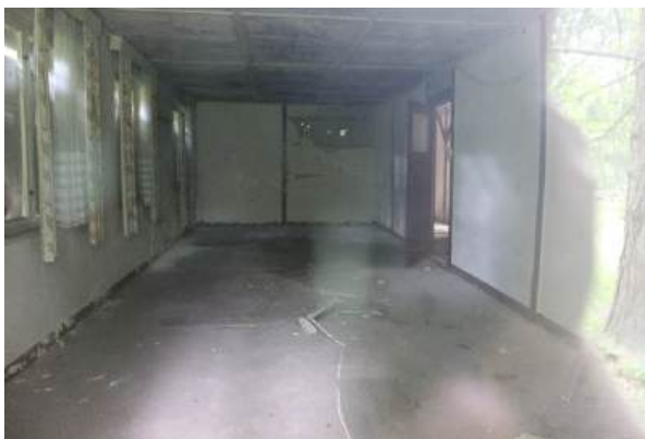
Abbildung 5: beispielhafte Innenansicht Bungalowruine
