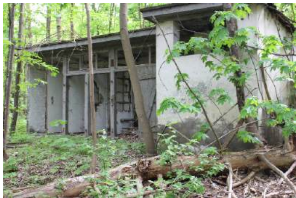
Abbildung 8: beispielhafte kleinere Sanitärruine
