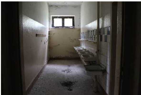
Abbildung 7: beispielhafte Innenansicht Sanitärruine
