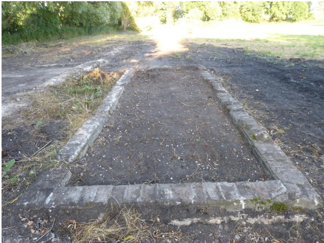
Bild 9: Fundamente mit Bauschutt Flächenbefestigung nordöstlich des großen Stallgebäudes
