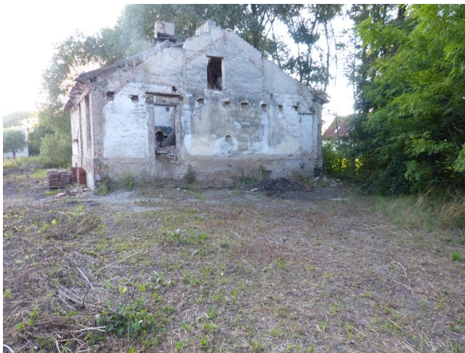
Bild 2: Gebäuderuine im Ostteil des geplanten Biohofs (Bereich geplante Sauna mit Terrasse)
