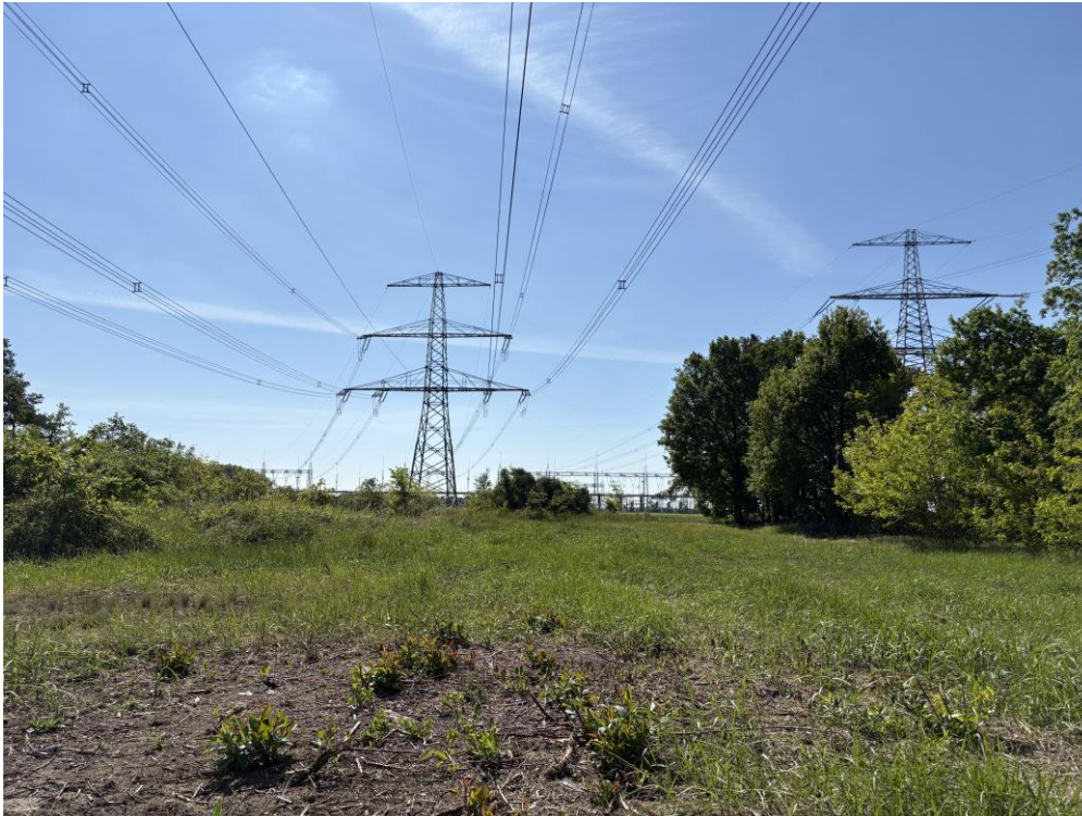
Abbildung 14: Stromtrasse nördlich des Umspannwerks, Foto vom 13.05.2025
