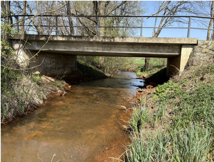
Abbildung 10: Wudritz mit Eisenoxidschicht, Foto vom 17.04.2025
