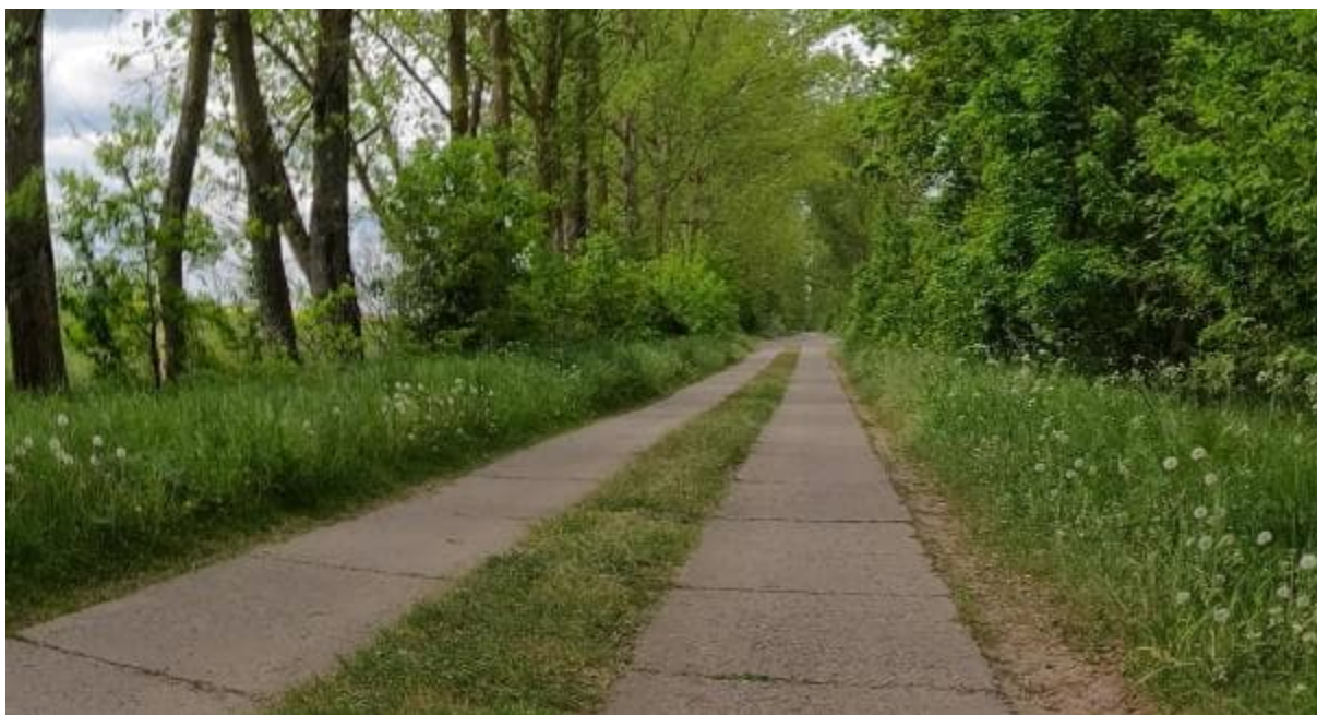
Abbildung 3: Zustand Weg im Norden - Am Tempelfelder Weg 3
