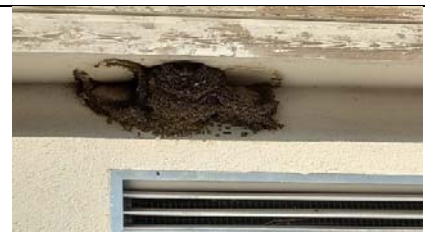
Nest 6 und 8: in 2025 Ausbau bzw. Wiederherstellung begonnen, aber abgebrochen.
