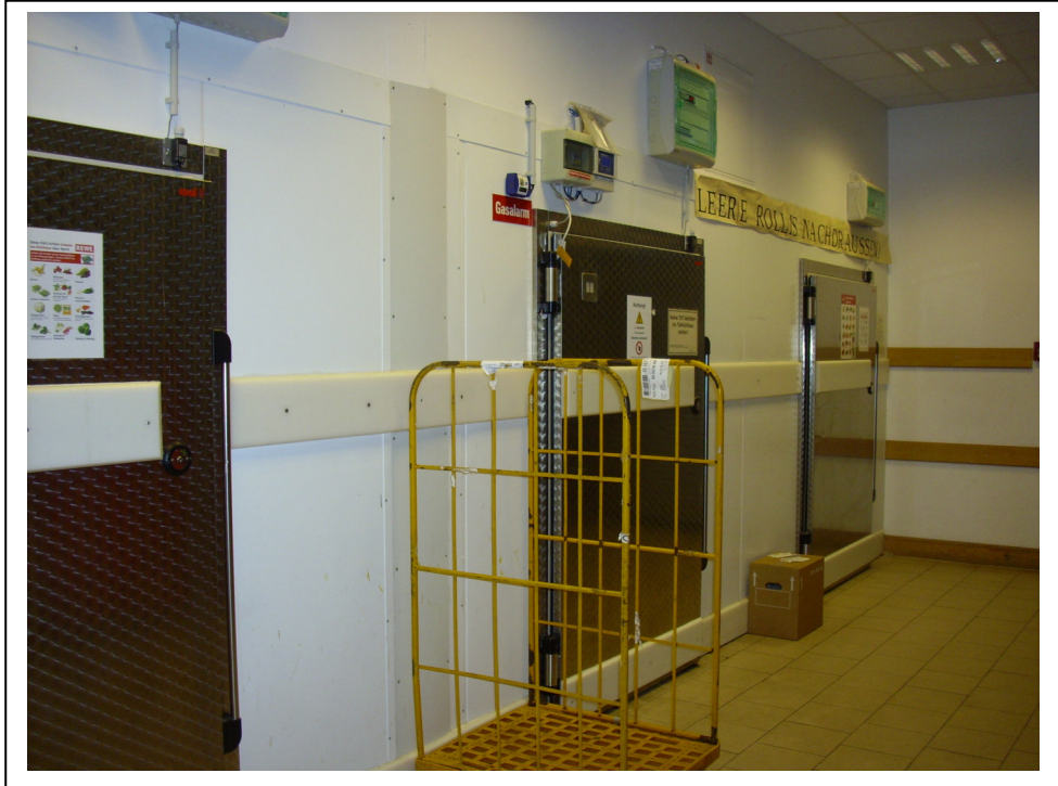
Foto 13: Kühl- und Tiefkühlzellen befinden sich u.a. im Lager des REWE-Marktes.
