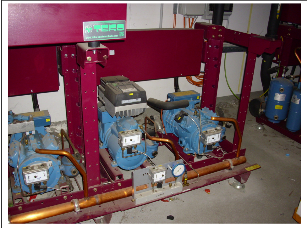
Foto 15: Blick auf 3 weitere der insgesamt 8 betriebenen Kälteaggregate.
