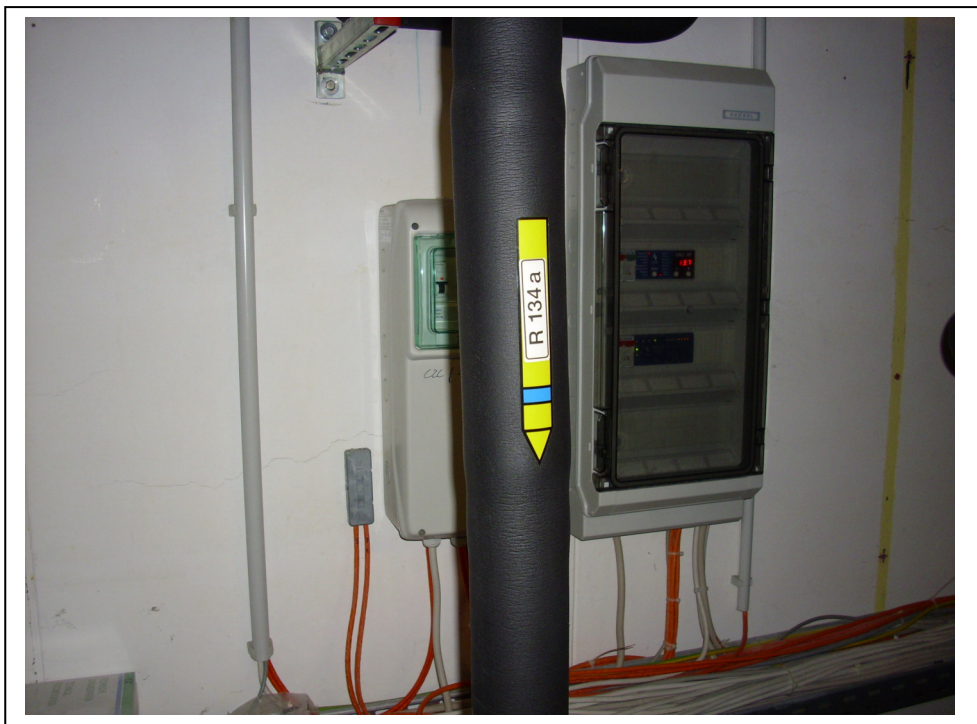
Foto 16: Blick auf das im Wesentlichen verwendete Kältemittel R 134 – klimaschädigend.
