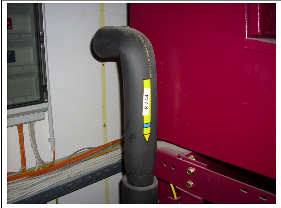
Foto 17: Blick auf das moderne Kältemittel R 744 – nicht klimaschädigend.
