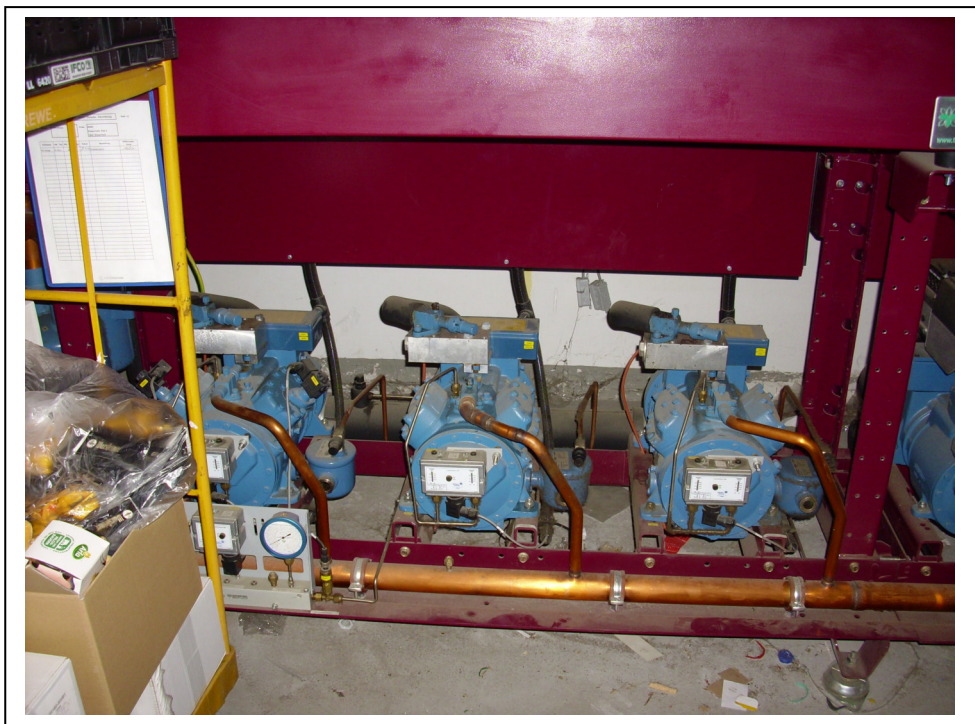
Foto 14: Blick auf 4 der insgesamt 8 betriebenen Kälteaggregate.
