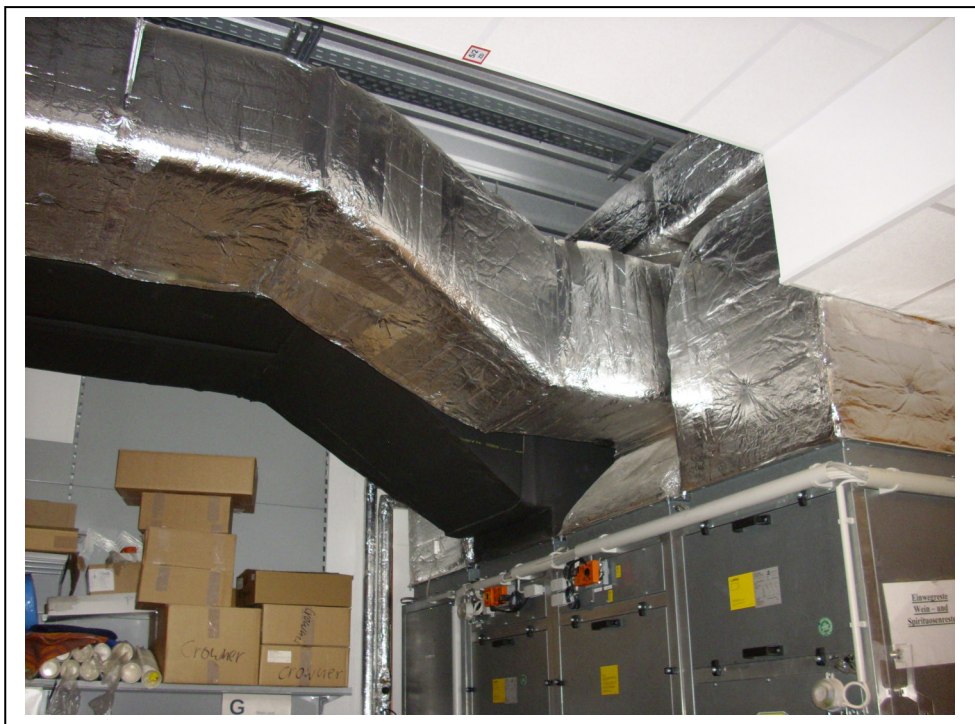
Foto 18: Blick auf mit KMF isolierte Lüftungsleitungen.
