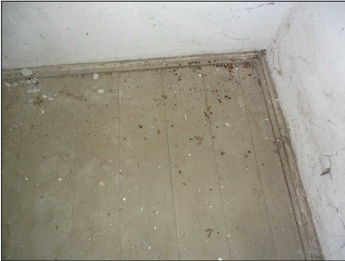
Bild 13 - Gutshaus, Innenbereich, Obergeschoss, weiterer Fraßplatz Fledermäuse mit Kotspuren
