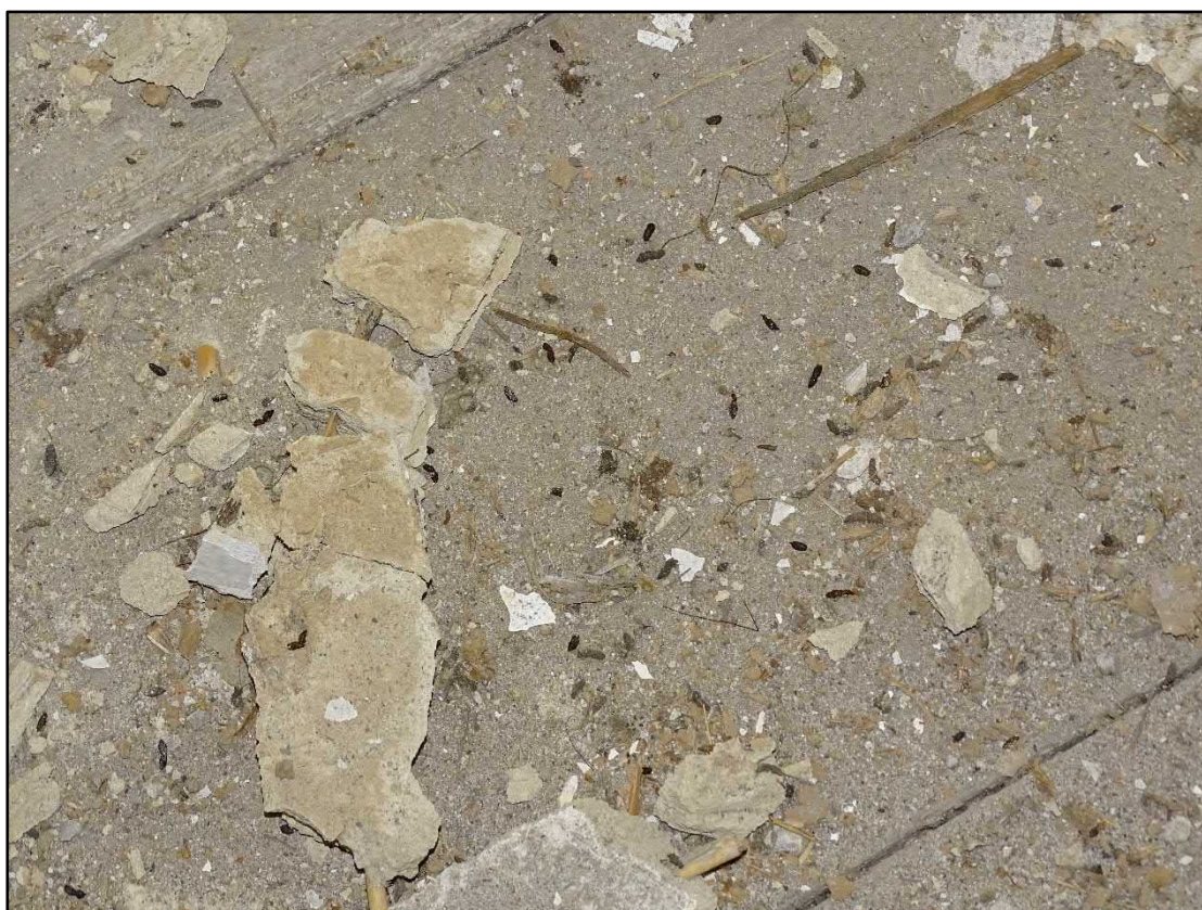
Bild 12 – Gutshaus, Innenbereich, Obergeschoss, Fraßplatz Fledermäuse mit Kotspuren
