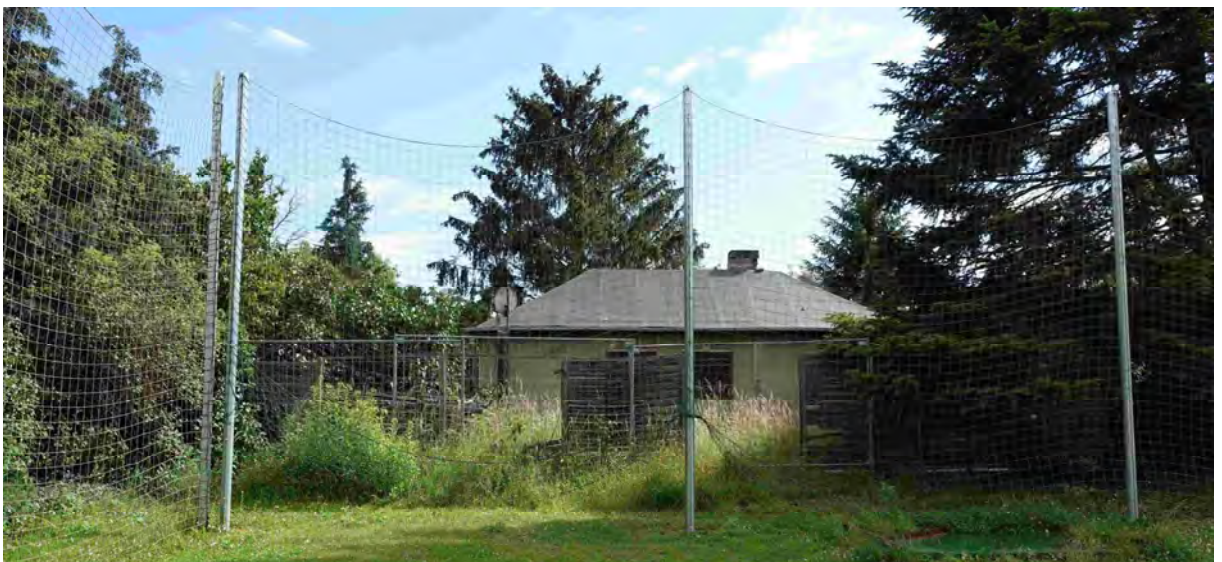
Abb. 07 Blick auf das brachgefalle Wohnhaus auf dem Grundstück Paul-Mewes-Damm 52, Flurstück 305. © Steffen Pfrogner 17.06.2024
