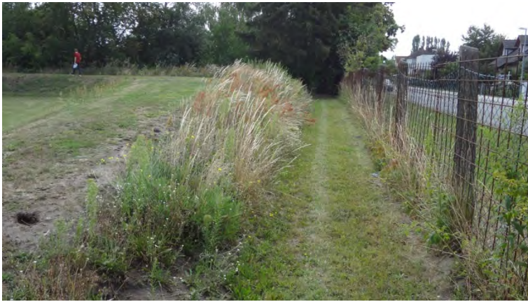
Abb. 43 Aufschüttung mit anteilig selten gemähter Böschungsrückseite
