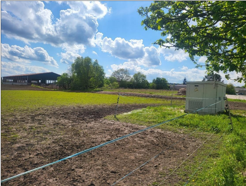
Abbildung 9: Trafo südwestlich im Untersuchungsgebiet
