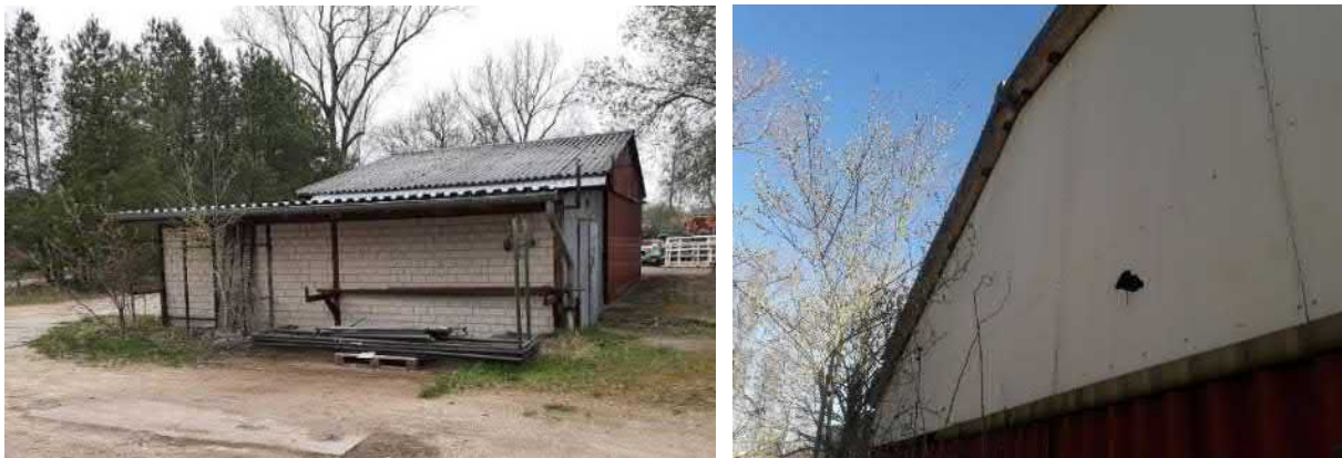
Abbildung 5.1-7: Südl. Rückwand Baute 2 / Längsseite Baute 2 mit Ebenasbestzement
