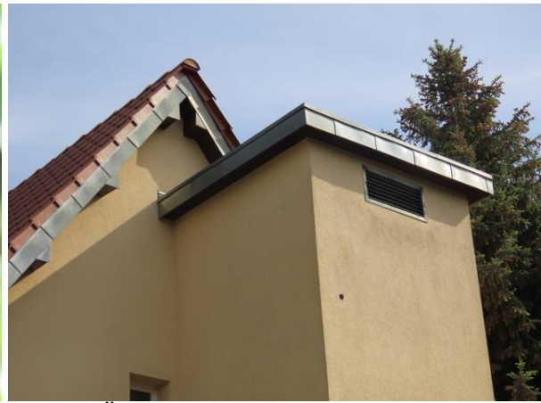
Abb. 21: Öffnung (Starenbrutplatz) in einer Fassadenöffnung
