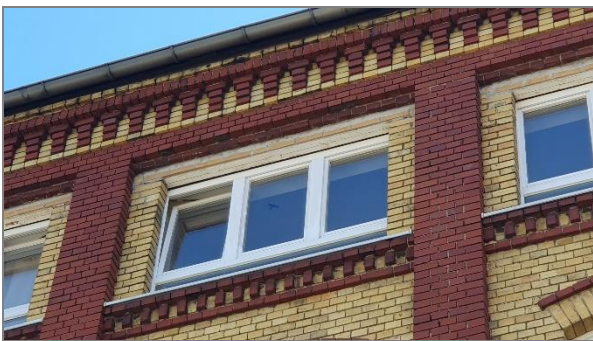
Abbildung 17: Spalt über Fenstern
