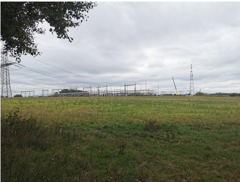
Bild 2: Überblicksbild S' Bereich mit Umspannwerk
