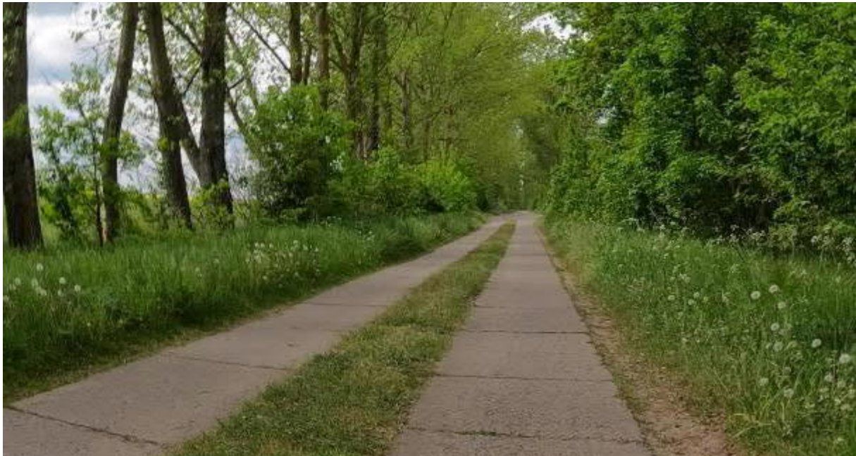
Abbildung 3: Zustand Weg im Norden - Am Tempelfelder Weg 3
