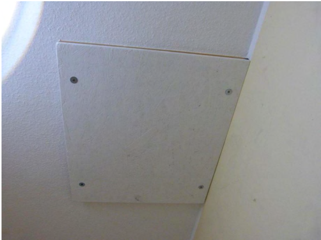
Bild 29: Verschraubte Dachluke im Wohnhaus Flst. 669/2
