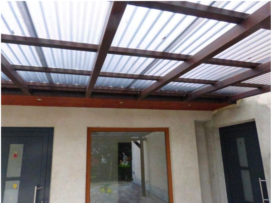
Bild 23: Untersuchung Überdachung Wohnhaus Flst. 669/3
