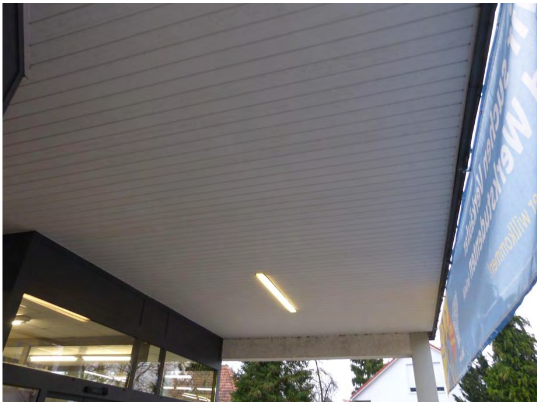
Bild 10: Untersuchung Eingang LIDL-Gebäude auf Löcher, Risse und Schwalbennester
