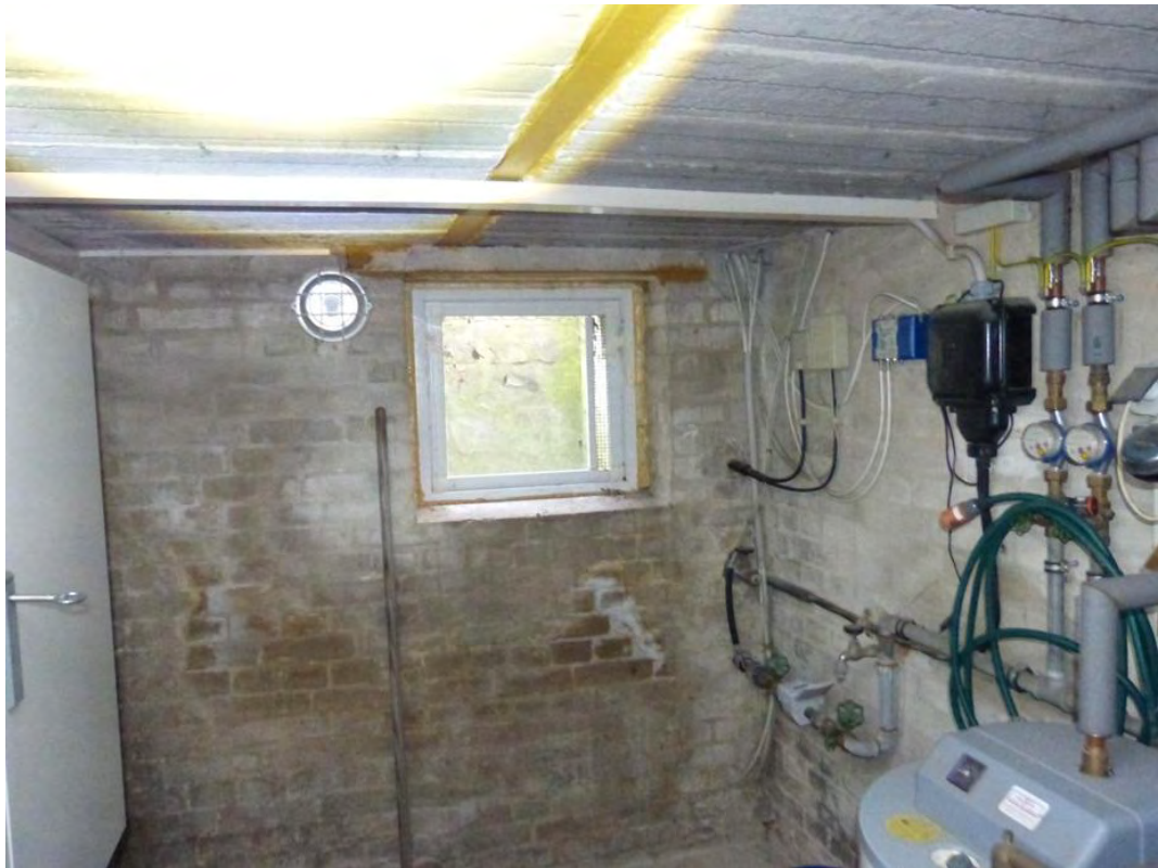
Bild 17: Untersuchung Keller im Wohnhaus Flst. 669/3
