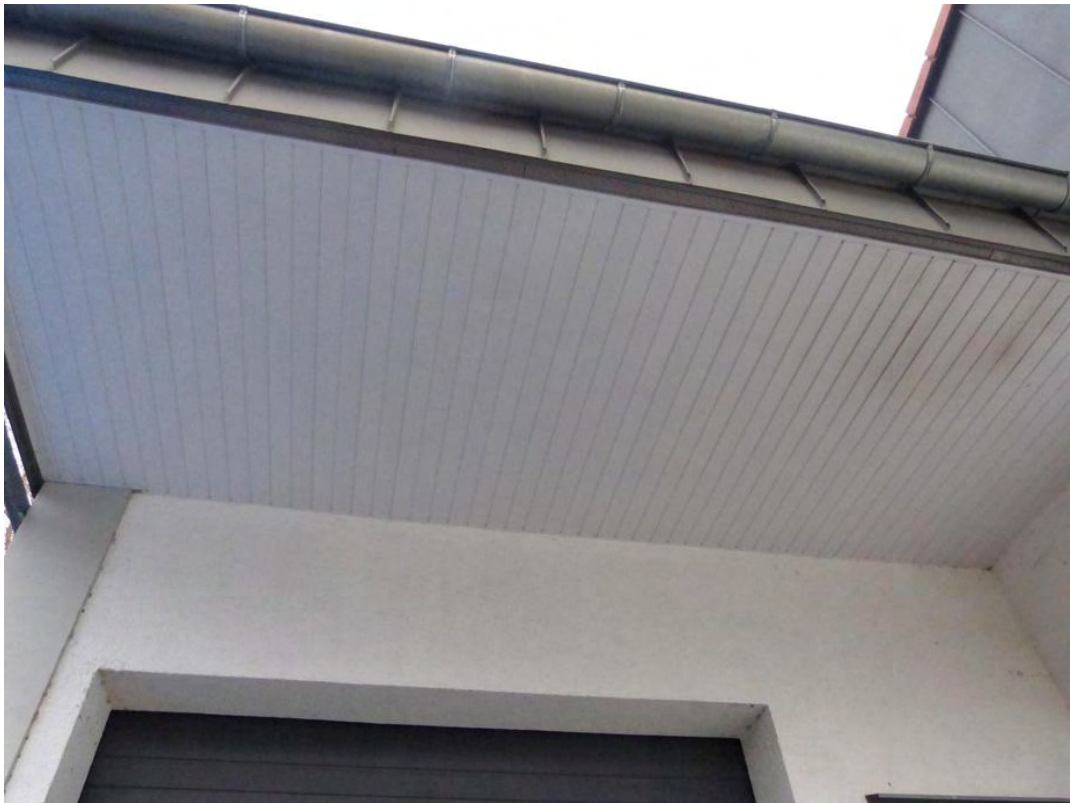
Bild 9: Untersuchung Überdachung LIDL-Einkaufsmarkt auf Löcher, Risse und Schwalbennester
