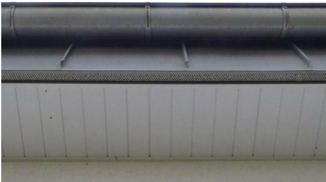
Bild 8: Untersuchung Außenhülle LIDL-Einkaufsmarkt auf Löcher und Risse
