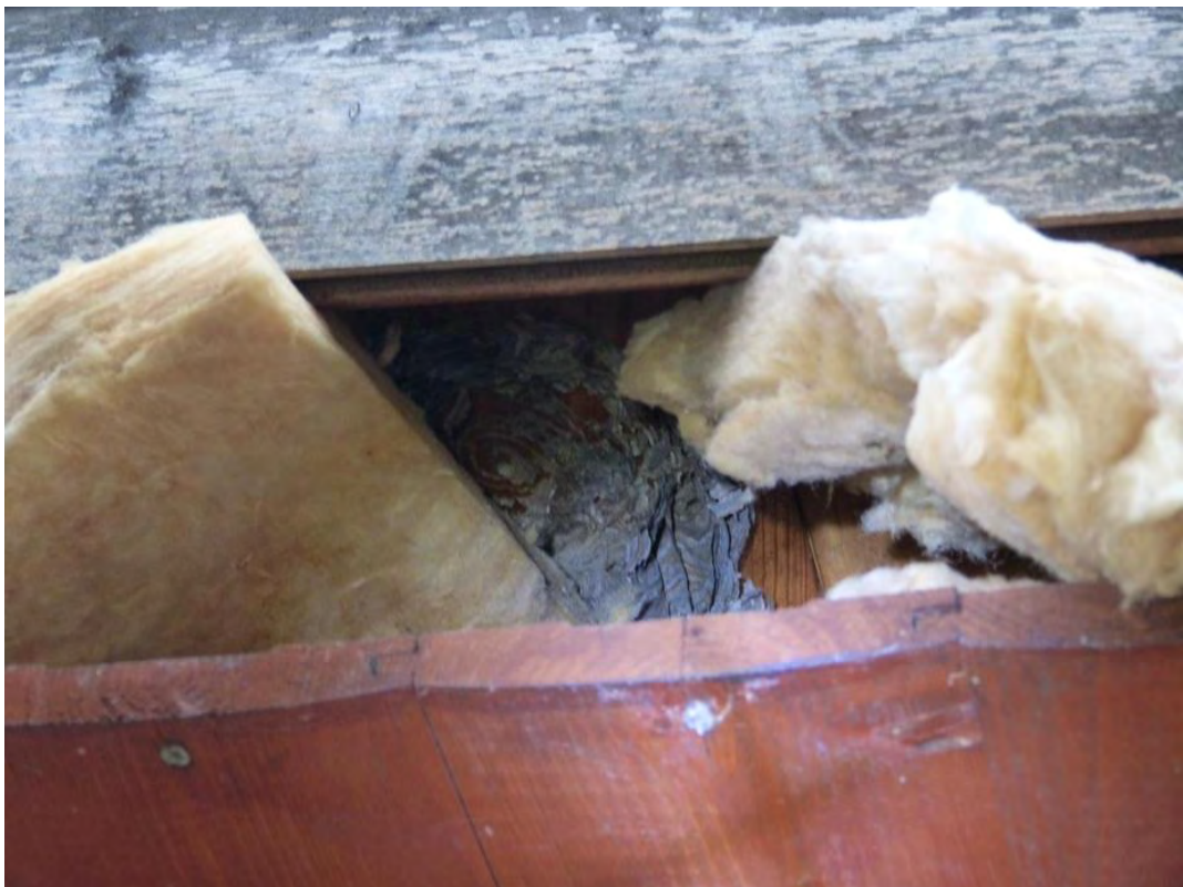
Bild 24: Zerfallenes altes Wespennest in Anbau des Wohnhauses Flst. 669/3
